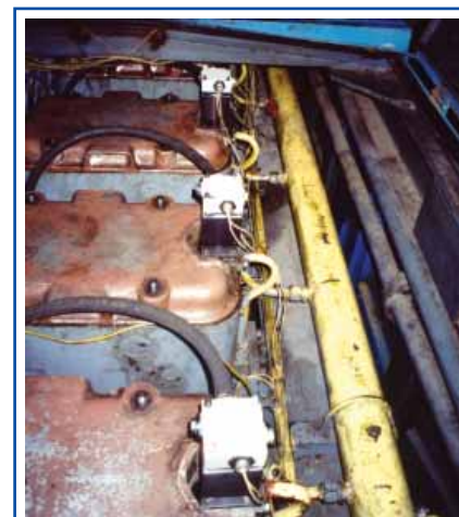
Рис. 3. Электромагнитные клапаны подачи газа типа ФУРСД-75 на цилиндрах газодизельного тепловоза ТЭМ2Г
