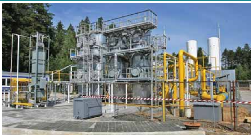
Комплекс СПГ на ГРС-4 (г. Екатеринбург) производительностью 3 т/ч
