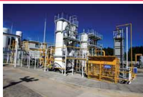
Комплекс производства СПГ на ГРС-4 в г. Екатеринбурге производительностью 3 т/ч
