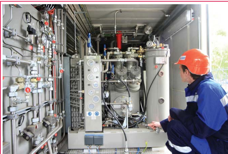
Рис. 3. Компрессорное оборудование АГНКС-2 г. Томск
