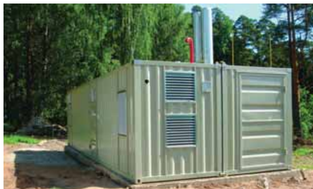
Рис. 4. Блочная автономная котельная фирмы «FAS», работающая на СУГ
