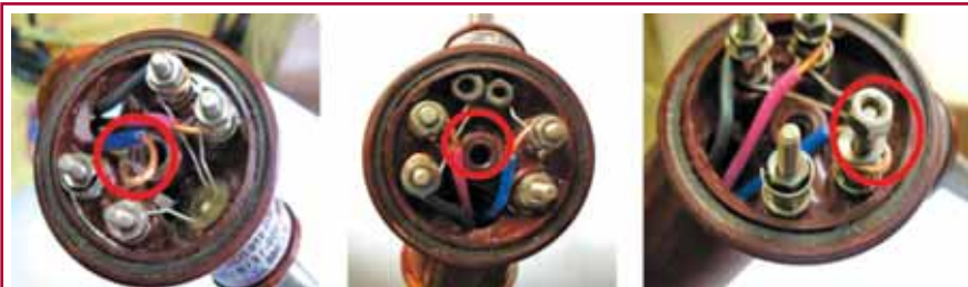
Рис. 2. Примеры ослабления крепления проводов и замыкания контактов
