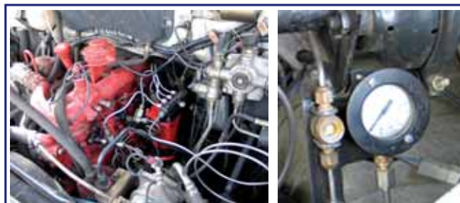
Рис. 8. Размещение топливной системы МГТУ им. Н.Э. Баумана в подкапотном пространстве автомобиля ЗИЛ-47303А «Бычок» (а); приборы контроля потока и давления ДМЭ под капотом (б)
