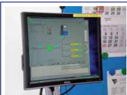
Мониторинг состояния технологического оборудования однокомпрессорной АГНКС
