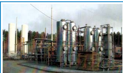
Рис. 3. Комплекс по производству СПГ на ГРС-4 (г. Екатеринбург)
