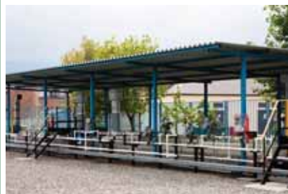
Бункеры с аккумуляторами газа
