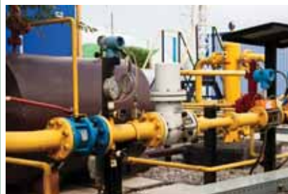
Блок входных кранов
