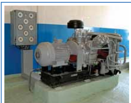
Рис. 5. Компрессорная с аккумуляторами сжатого воздуха на 20 и 0,6 МПа
