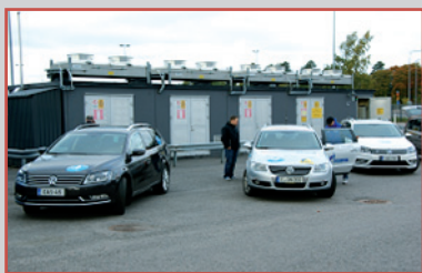
Компрессорный блок в муниципальном автобусном парке Хельсинки
