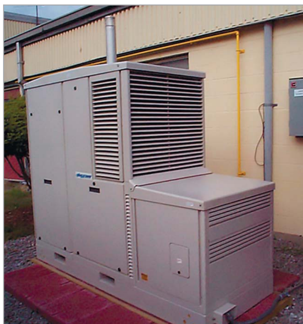
Рис. 13. Размещение топливного элемента SU-1
