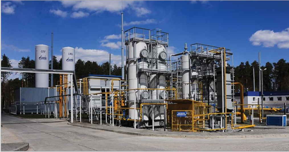
Комплекс производства СПГ на ГРС-4
